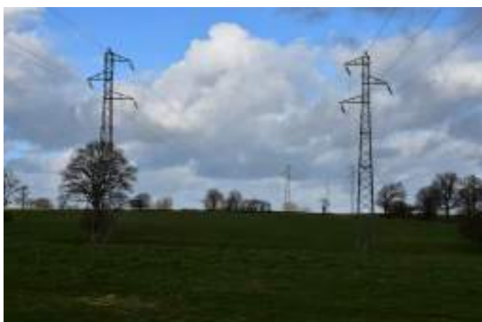
Pilones de lignes à haute-tension dans l'AEI entre la ZIP 3 et 3 bis.
